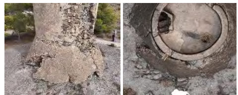
Figs. 5a, 5b- Imagen y planta que muestran la rotura del alambor provocada, fundamentalmente, por las aguas procedentes del vierteaguas
