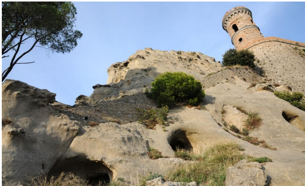
Fig. 1- Aggrottamenti a Caccuri in prossimità del castello (foto di Rosario Chimirri, 2016)
