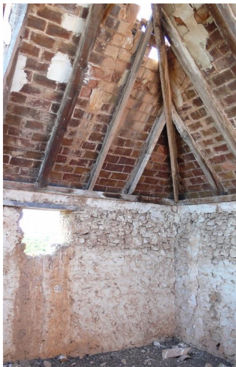
Fig. 5- Estado de la cubierta en 2016 (foto autor)
